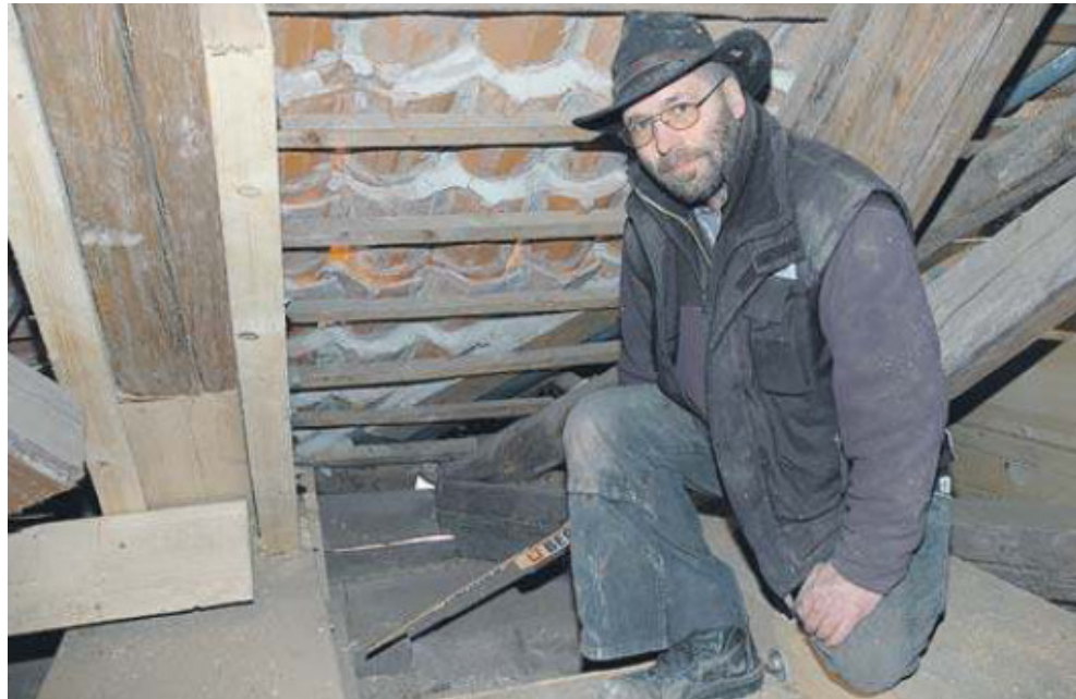
Zimmermann Bernd Lagershausen an einem Dachbalken, dessen unterer Teil abgesägt und durch neues Holz verlängert werden musste. Darüber hinaus haben die Handwerker den Balken an den Seiten verstärkt.
